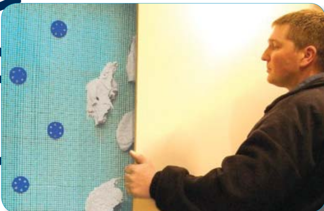
Als alternatief voor pleisterwerk, is het ook mogelijk om gipskartonplaten rechtstreeks op het membraan te lijmen
